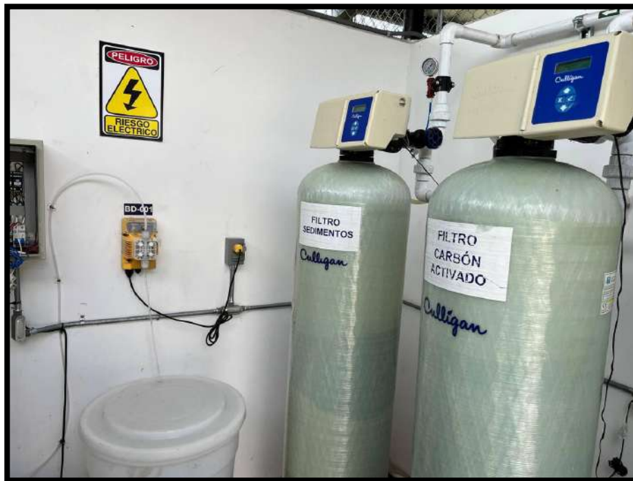
Fotografía No. 16. Área de potabilización de agua
