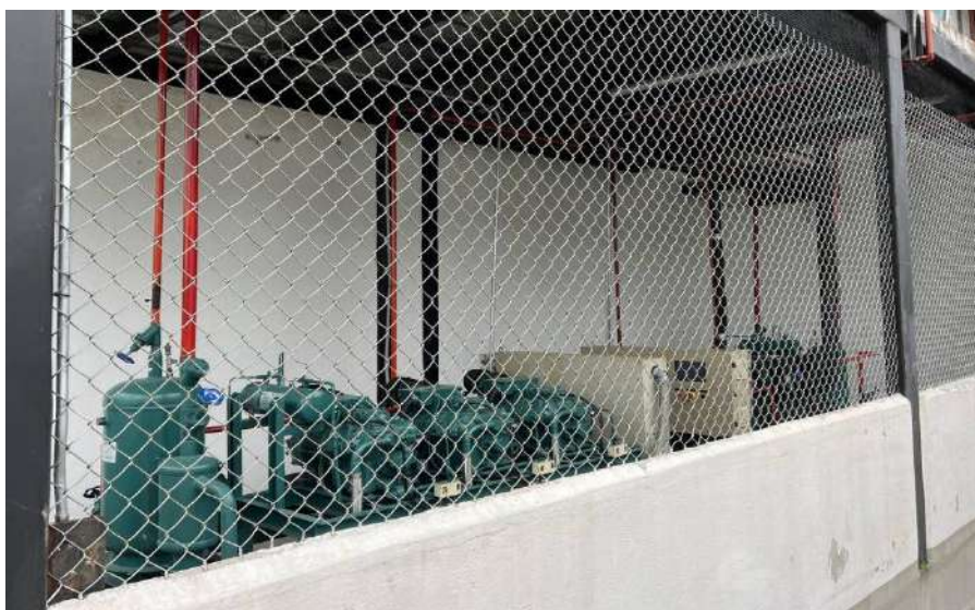
Fotografía No. 10. Área de Racks – Foproca
