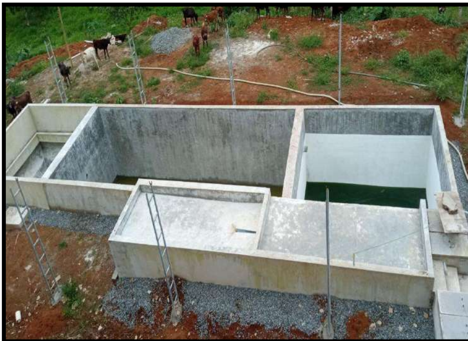
Fotografía No. 17. Planta de Tratamiento de agua residual (PTAR)
