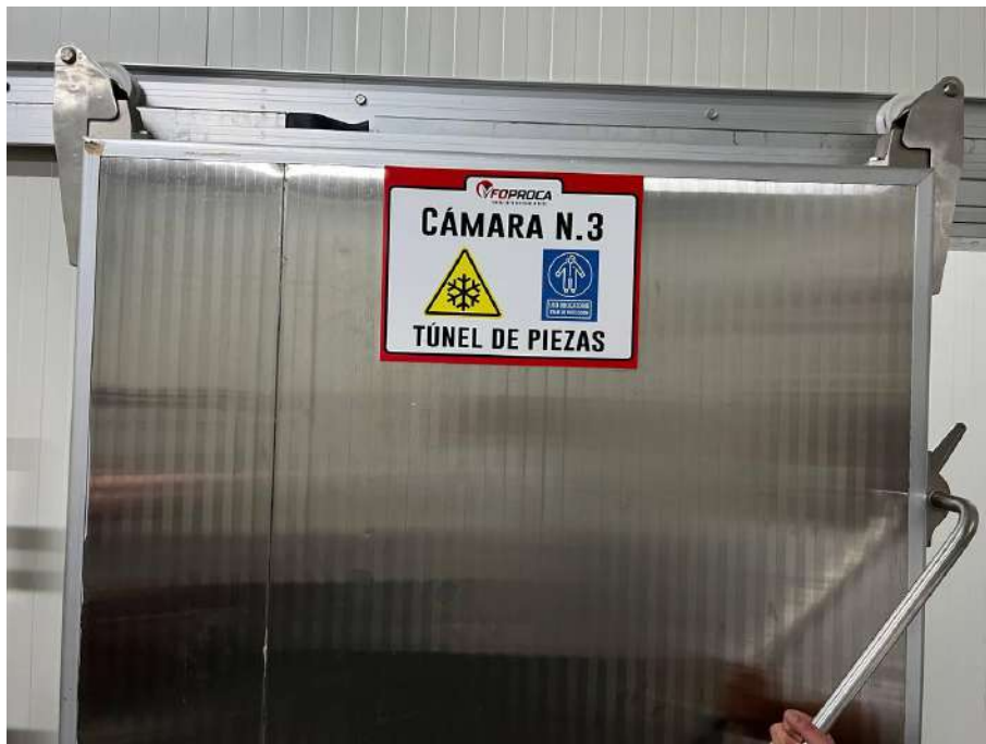
Fotografía No. 6. Cámaras de refrigeración para cortes
