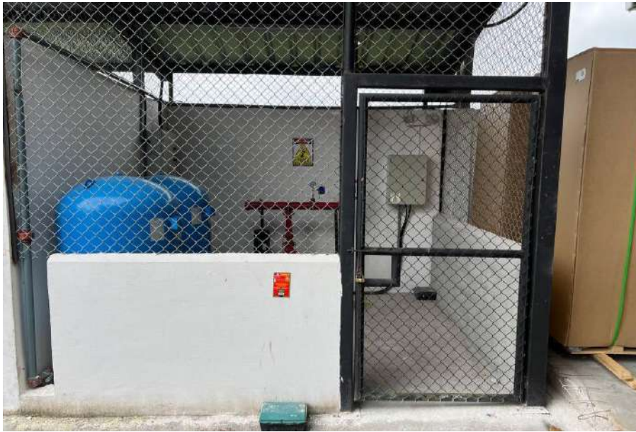
Fotografía No. 9. Área de presurización de agua
