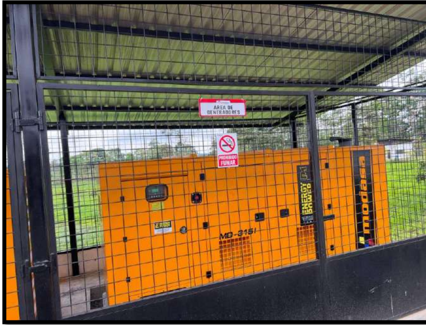
Fotografía No. 18. Generadores Eléctricos
